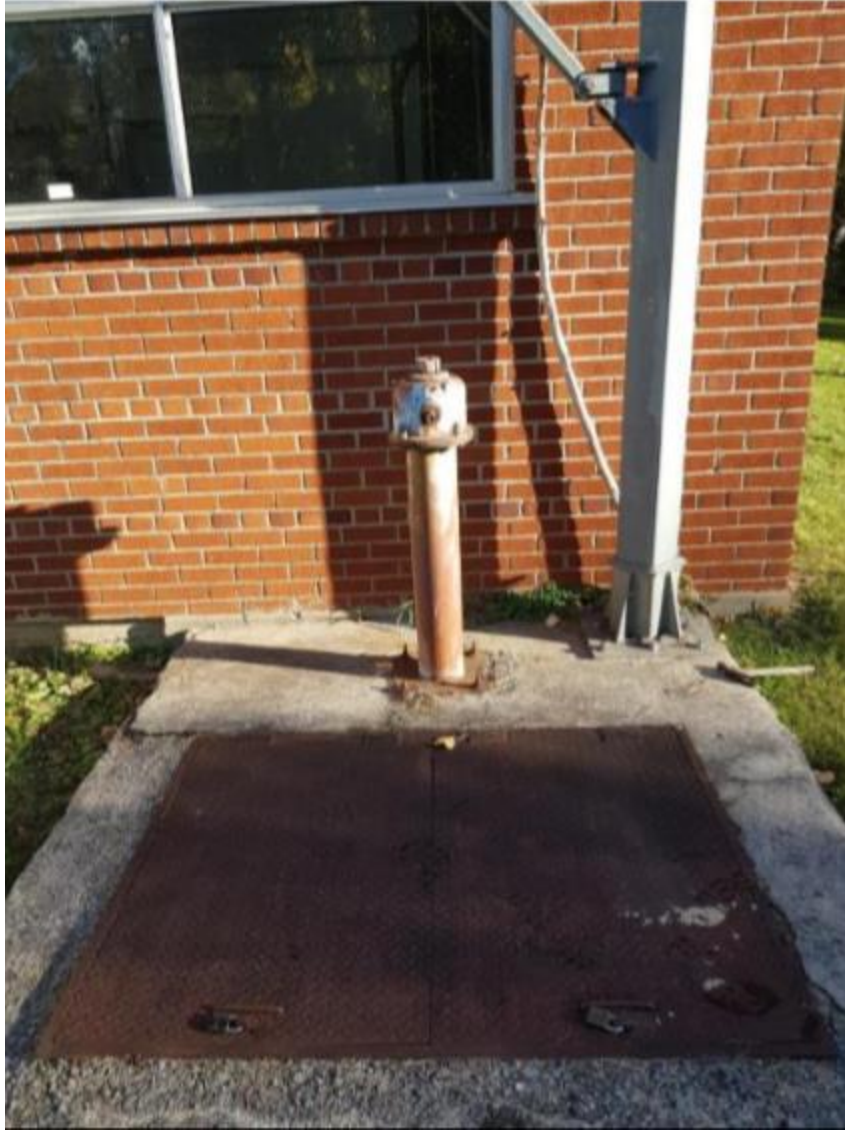
Chambre des grilles adjacente à l'usine de filtration – vanne pour la conduite 1070 mm
