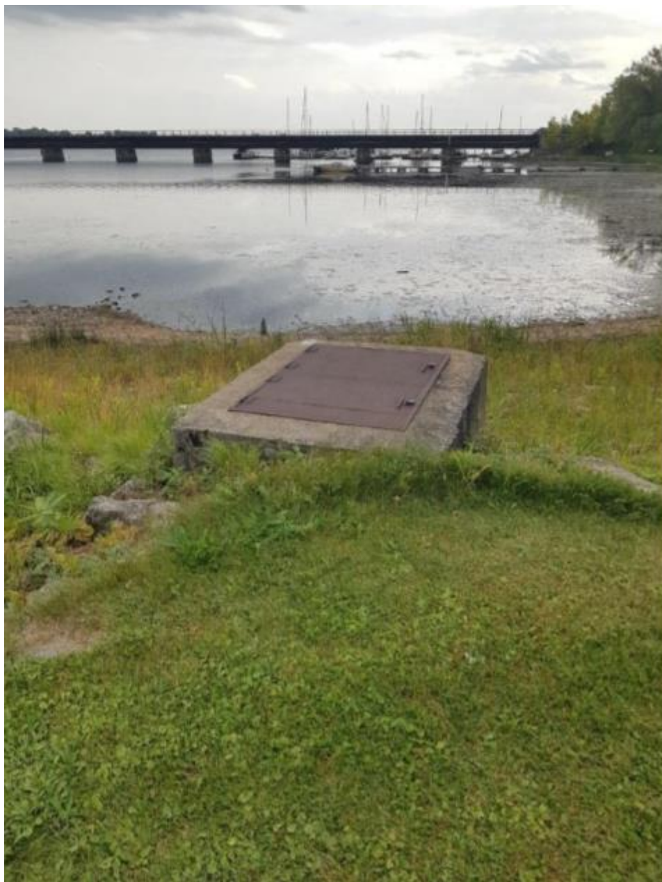
Regard d'accès sur la rive - conduite 1070 mm
