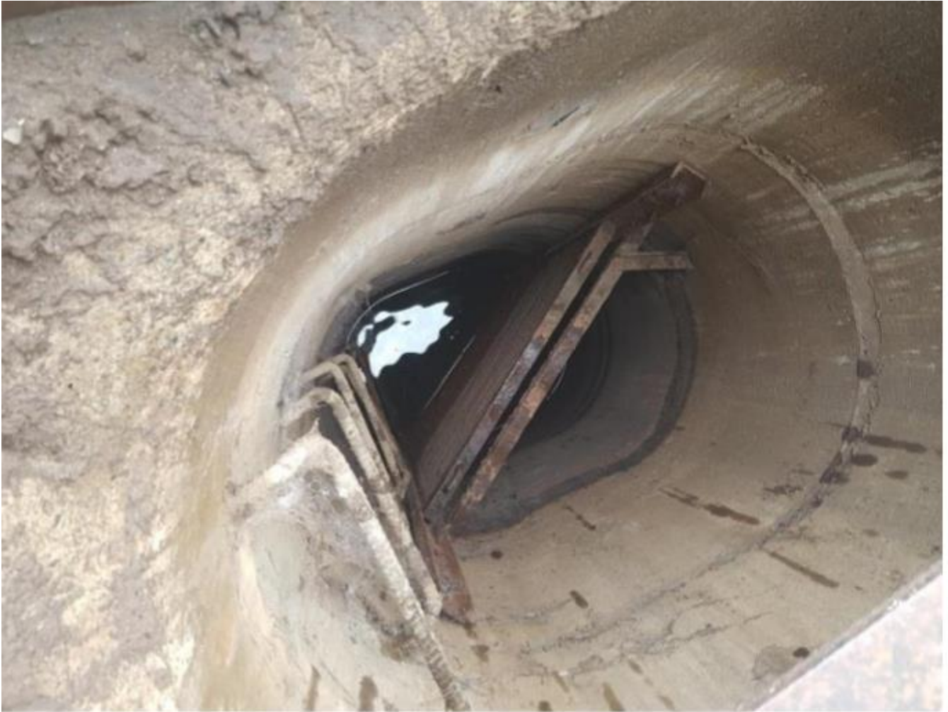
Puits ovale des grilles pour la conduite 450 mm
