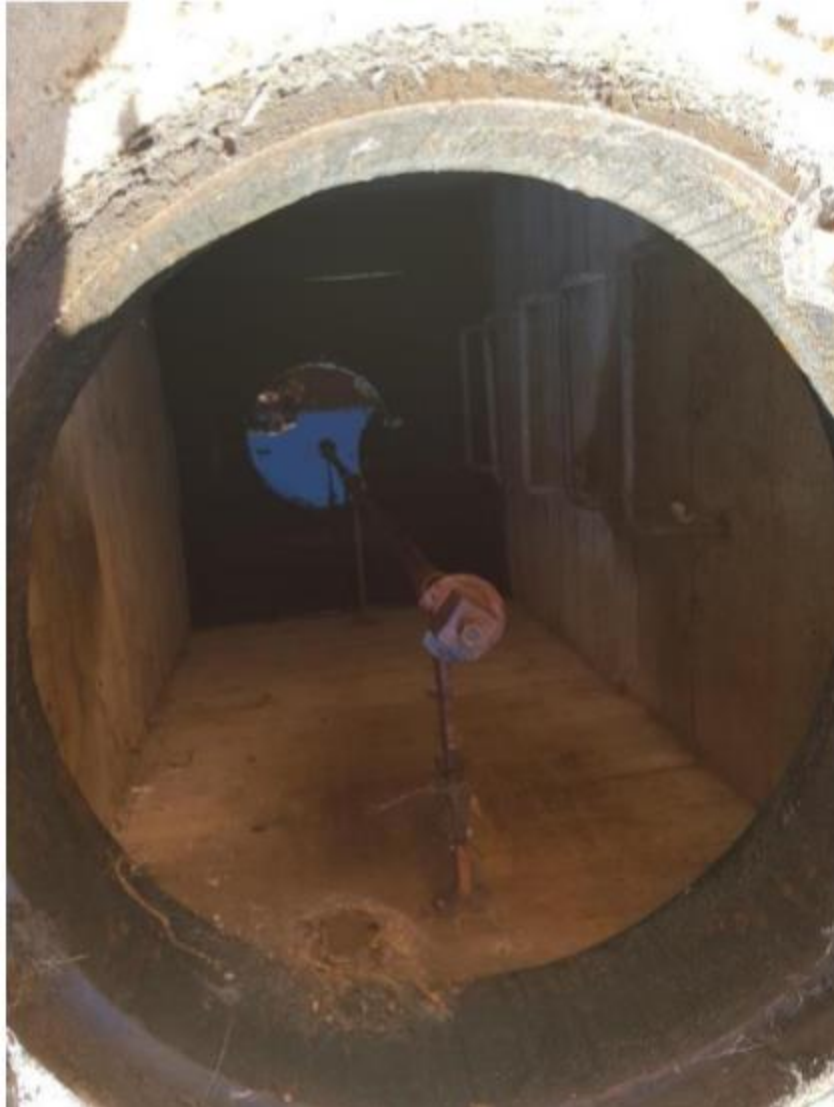
Vanne d'isolement de la conduite 450 mm au niveau de l'usine
